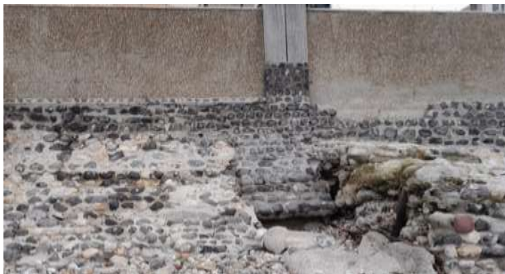
Abaissement de la plage : dégradations du perré en amont de l'épi n°8 avec ici une initiation de brèche (photo 2023)
