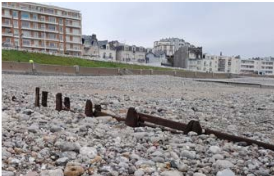
Epi n°8 actuel en état de ruine
