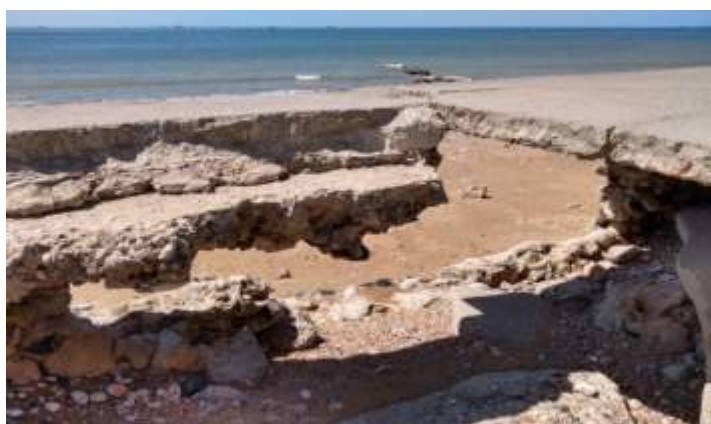
Effondrement de la promenade à Sainte-Adresse après brèche dans le perré au droit d'une partie déficitaire de la plage en galet (« digue du bout du monde » photo 2020)
