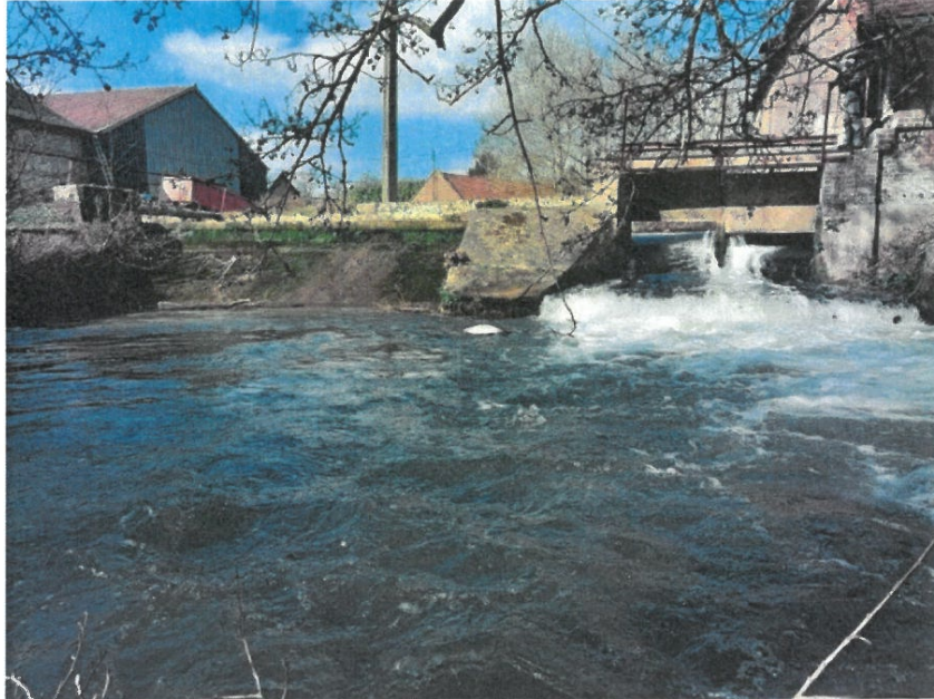
Photo 1 : Vannage de décharge et déversoir (ROE88749)
