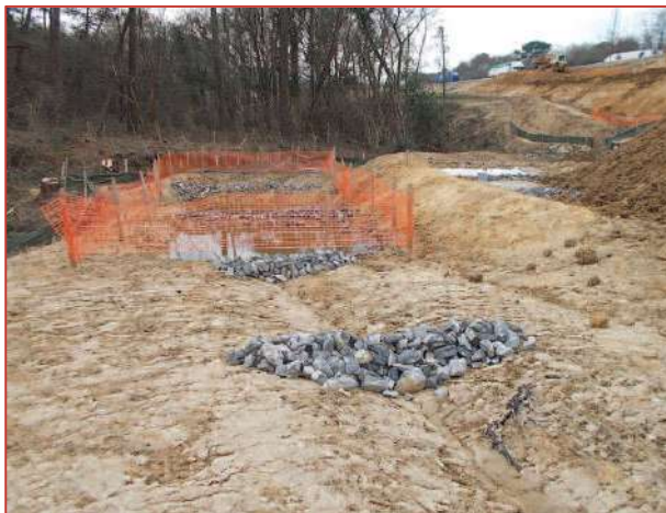
↑ Noue équipée de seuils en granulats concassés
