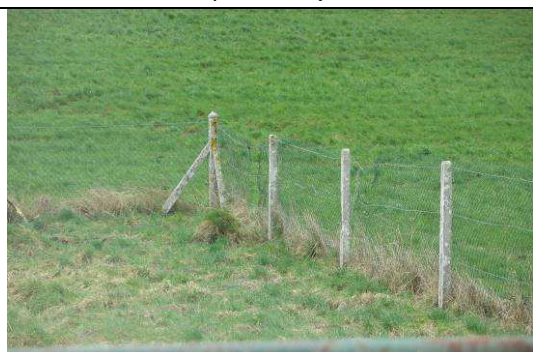
Clôture en grillage dégradé d'une hauteur de 1.6 m seulement à remplacer (hauteur 2 m)
