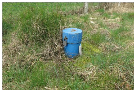
Tête du piézomètre à munir d'une détection intrusion (sonde de niveau seulement présente actuellement)
