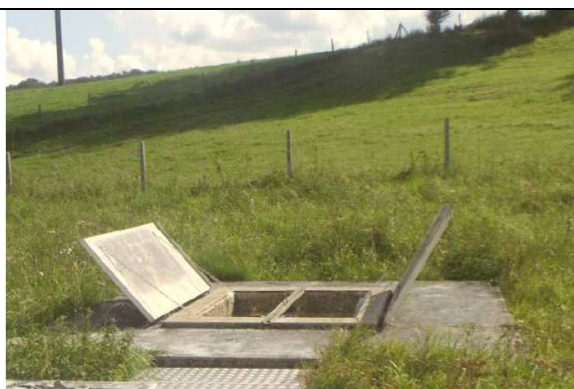
Captage dans un avant puits éloigné de 5 m en arrière du bâtiment technique
