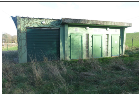
Bâtiment abritant le puits de prélèvement muni de plusieurs portes d'accès et d'un local de stockage de matériel (porte type garage sur la partie gauche)
