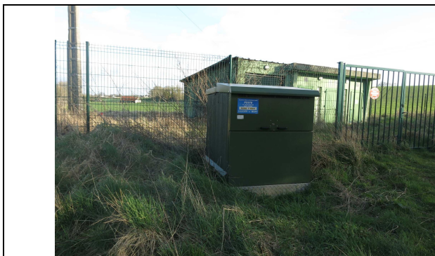
Poste de transformation électrique accolé au périmètre de protection immédiat
