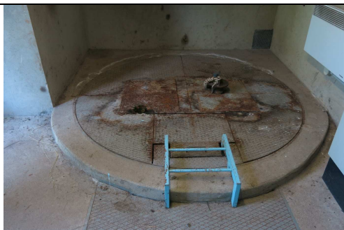
Plaques en acier non jointives sur l'ouverture du puits
