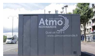
Figure 4 : Station fixe de mesures automatiques. Ici : quai de Paris - Source : Atmo Normandie
