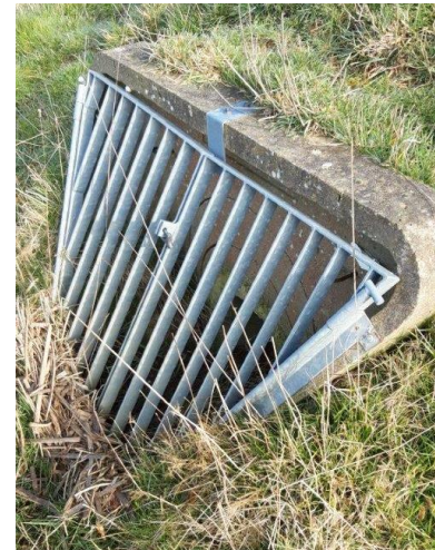
Figure 81 : Exemple de tête d'aqueduc
