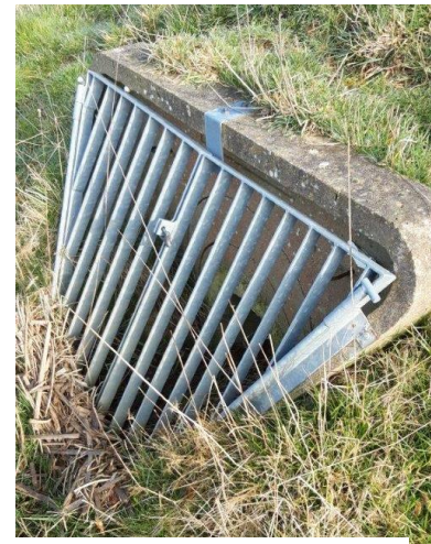
Figure 29 : Exemple de tête d'aqueduc
