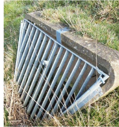
Figure 63 : Exemple de tête d'aqueduc
